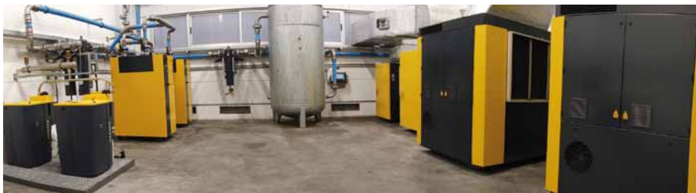
Sala compressori, fonderia.
